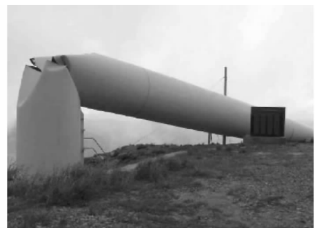
图 1 塔筒结构的实际破坏情况
