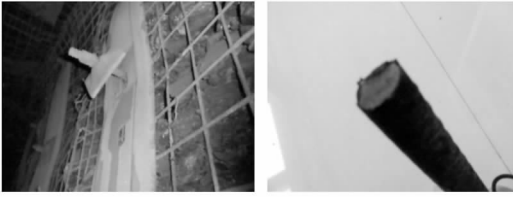
图5 锚杆崩盘失效
