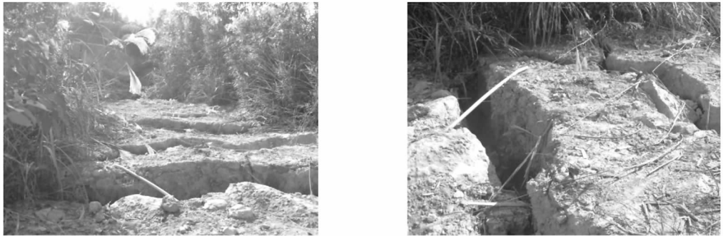
图4 滑坡后缘张裂缝
