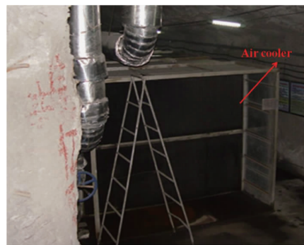
图 3 张双楼煤矿西翼-1 000 m 采掘面的空冷器
